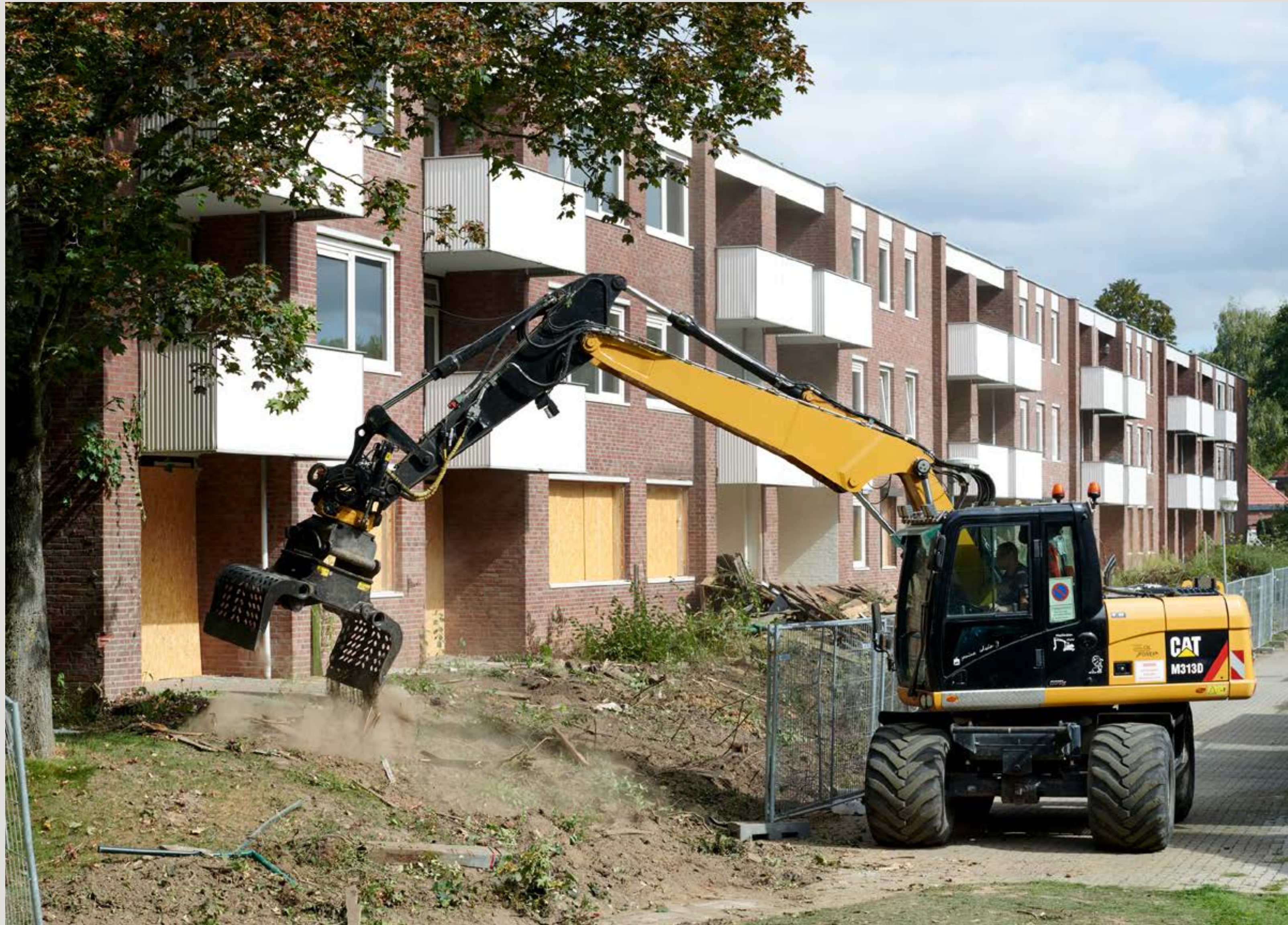
Bij de transformatie van Treebeek wordt slim gesloopt om materialen als beton, bakstenen en onderdelen van bijvoorbeeld keukens en badkamers opnieuw te gebruiken.
