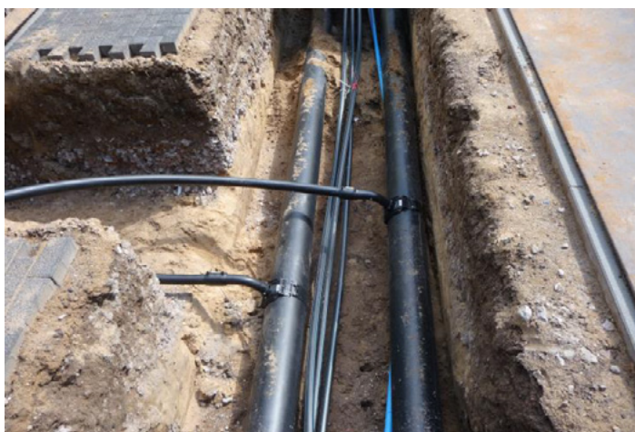
Figuur 7.9 | voorbeeld twee-pijps distributienet met aftakking
